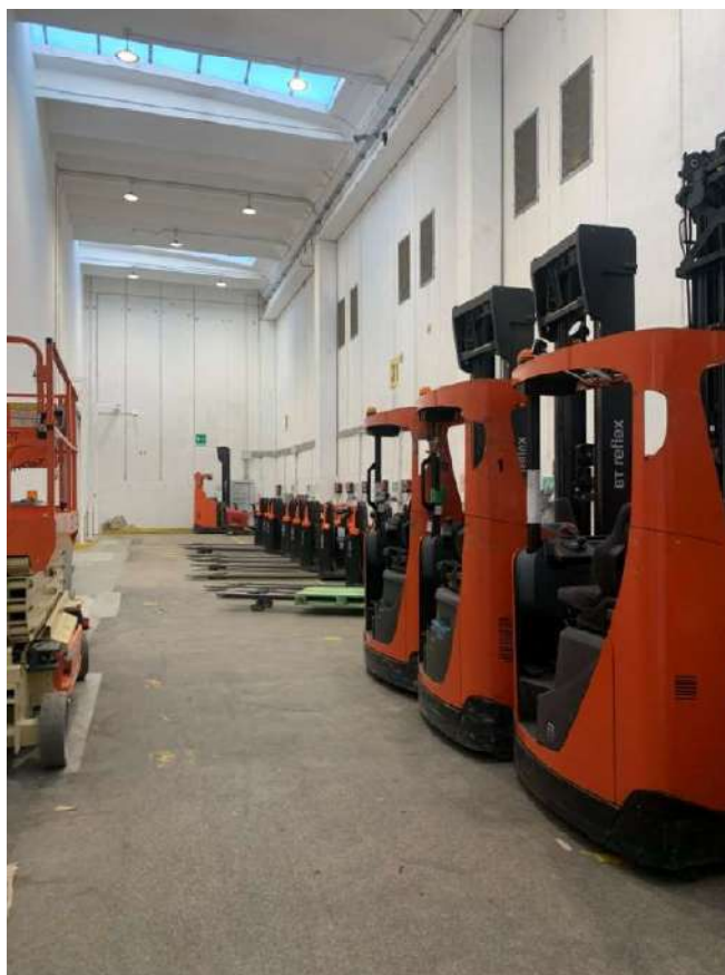
Locale carica batteria muletti piano terra
