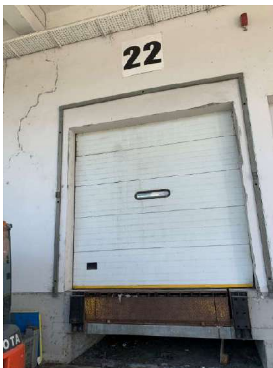
Accesso carico e scarico con lesioni murarie
