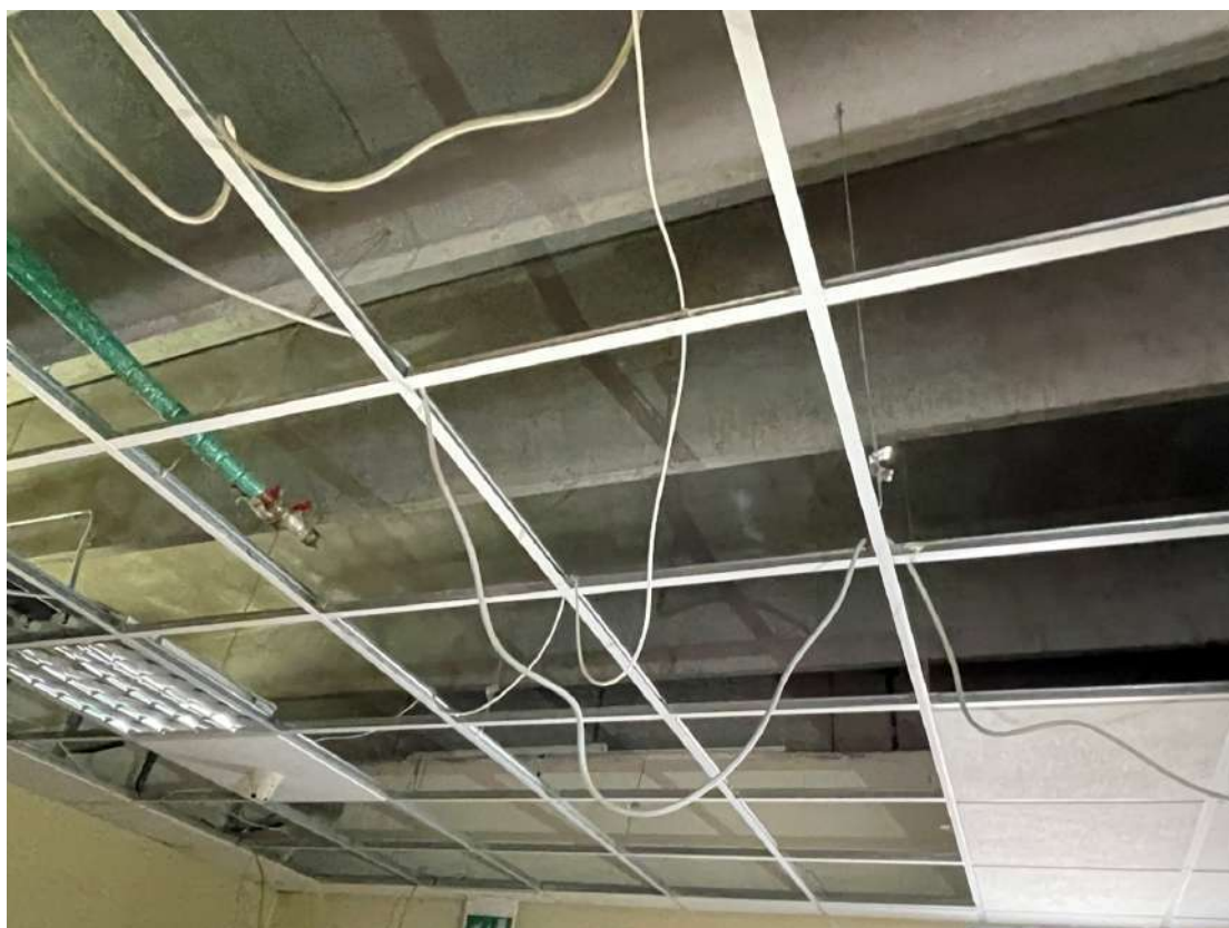
Zona Uffici secondo soppalco- Pannelli mancanti
