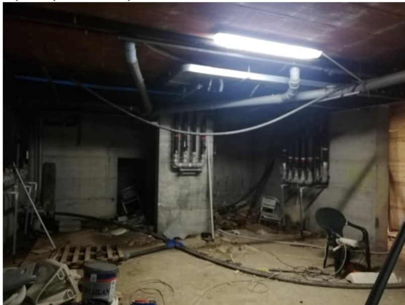
Foto 31) 32) 33) 34) Impianti presenti nel piano interrato.
