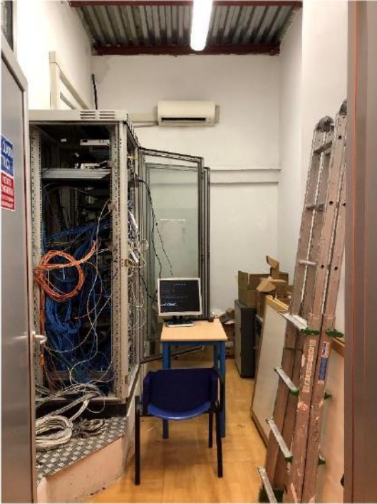
Foto 63 - VANO SCALA TRASFORMATO IN SERVER
