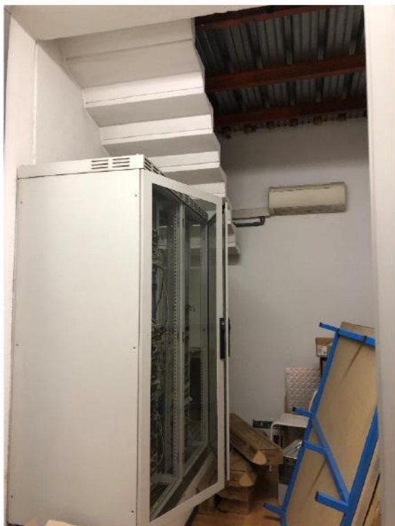
Foto 83 - vano scala trasformato in server
