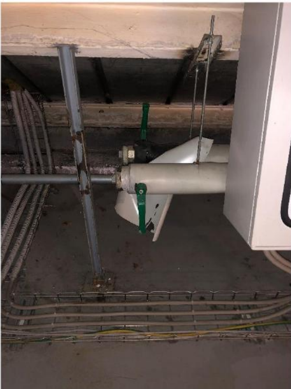
180 – impianto pompa di calore
