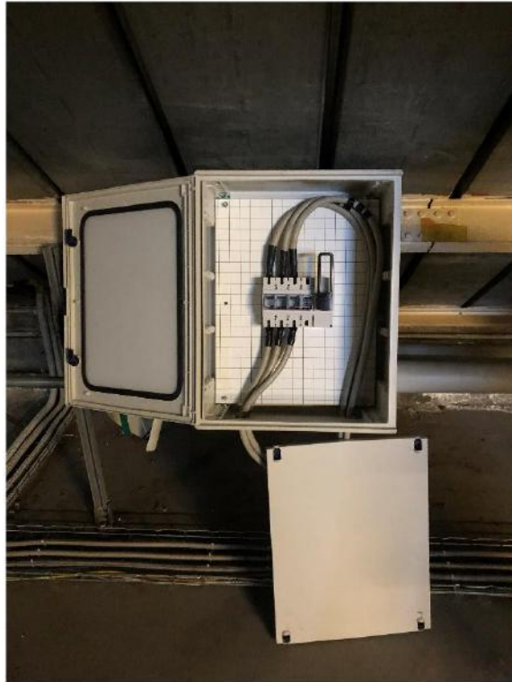
179 quadro elettrico pompa di calore
