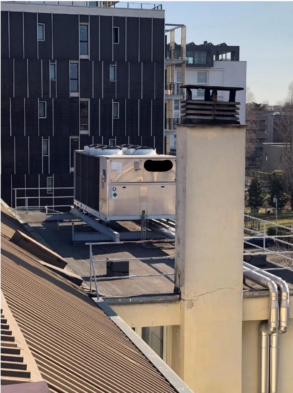
23 – Pompa di calore
