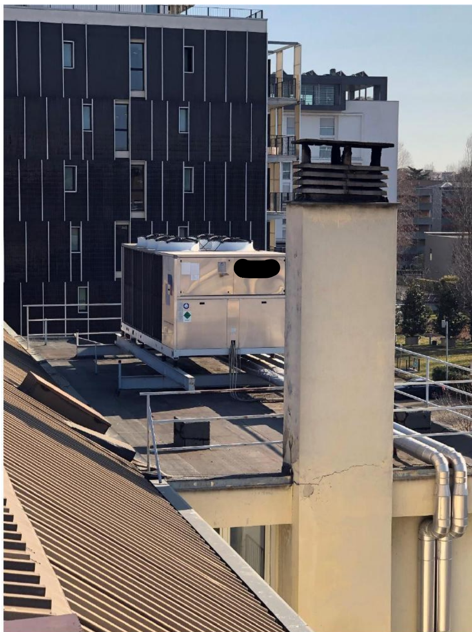
23 – Pompa di calore
