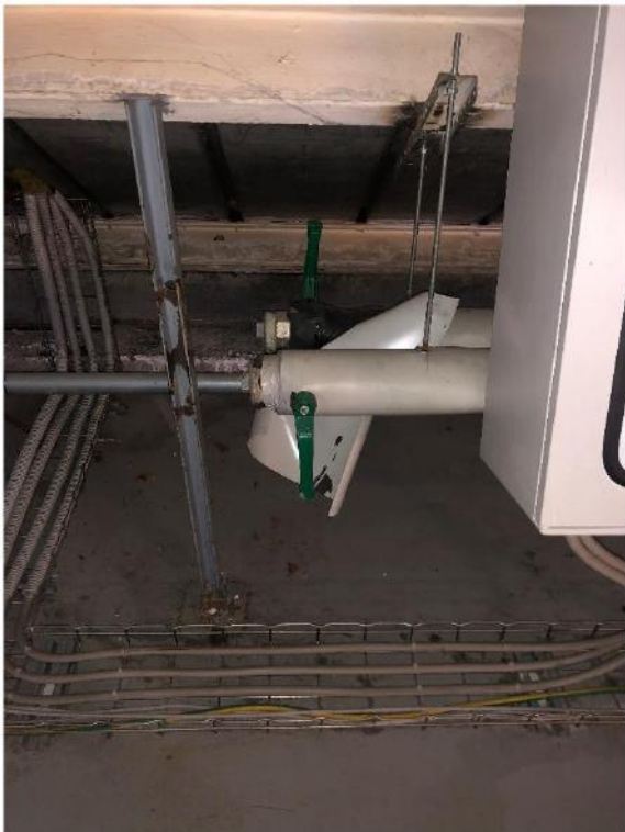
180 – impianto pompa di calore
