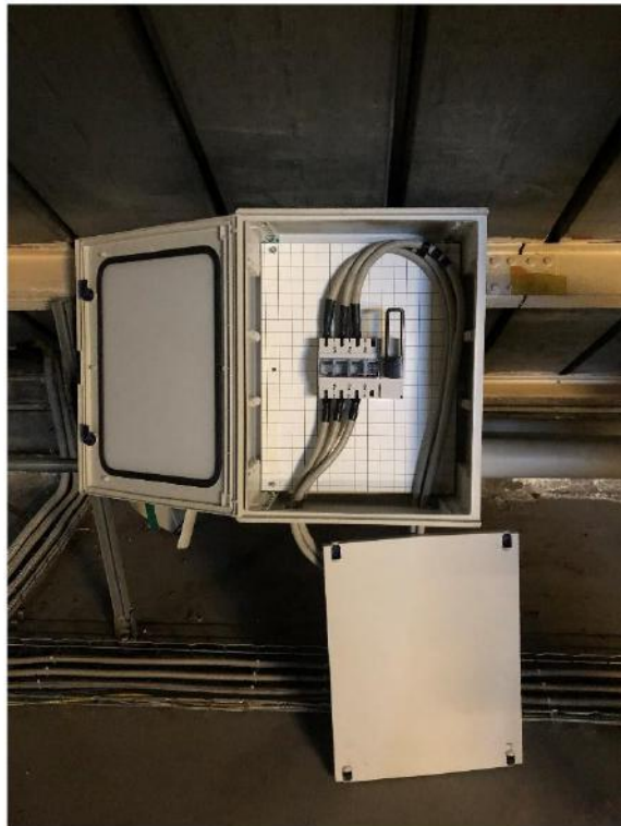
179 quadro elettrico pompa di calore
