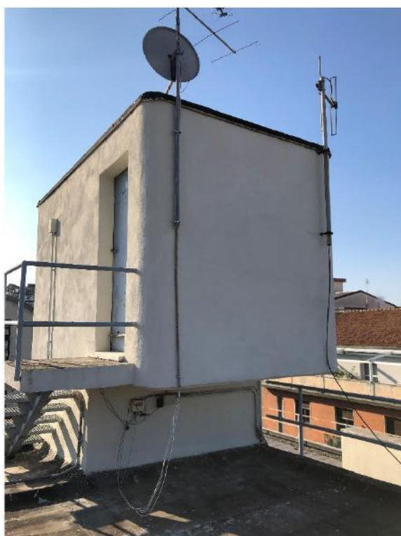
20 – Vano tecnico ascensori
