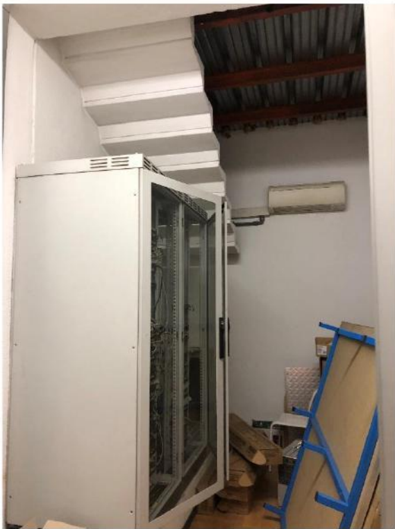
Foto 83 - vano scala trasformato in server
