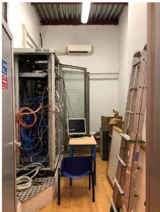
Foto 63 - VANO SCALA TRASFORMATO IN SERVER
