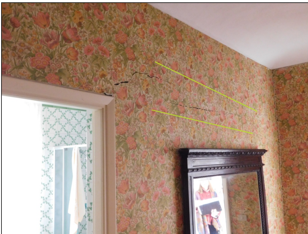
Assestamento strutturale al P.1 in locale soprastante il porticato esterno voltato in mattoni.
