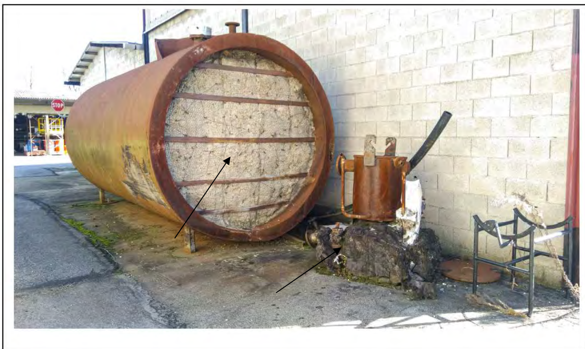
Fotografia 9: serbatoio dismesso in stato di abbandono depositato a lato del magazzino 12 E contenente all'interno si presume bitume solido e esternamente si vede parte della coibentazione presumibilmente in lana ceramica o lana di roccia, a fianco è depositato un rottame ferroso contaminato da bitume.
