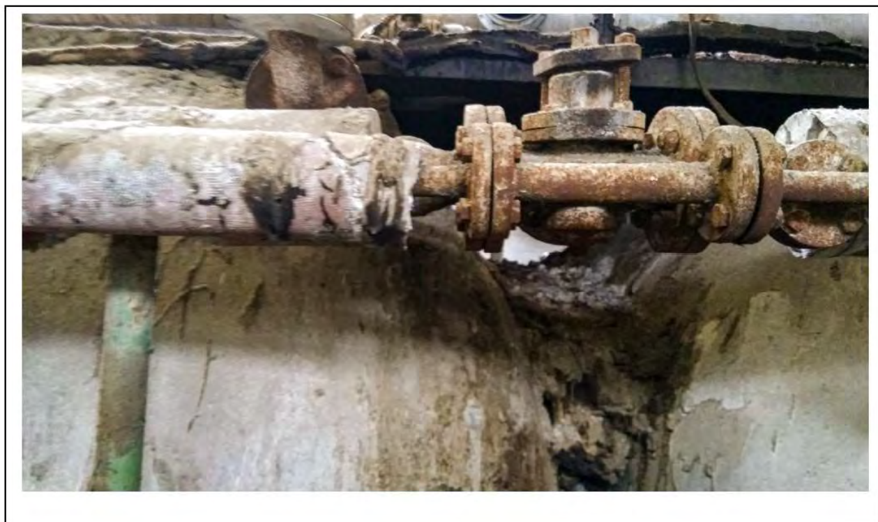
Fotografia 4: particolare indicante lo stato di conservazione di alcune parti di impianti dismessi da anni con potenziale esposizione di fibre di amianto.
