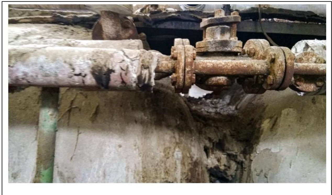
Fotografia 4: particolare indicante lo stato di conservazione di alcune parti di impianti dismessi da anni con potenziale esposizione di fibre di amianto.
