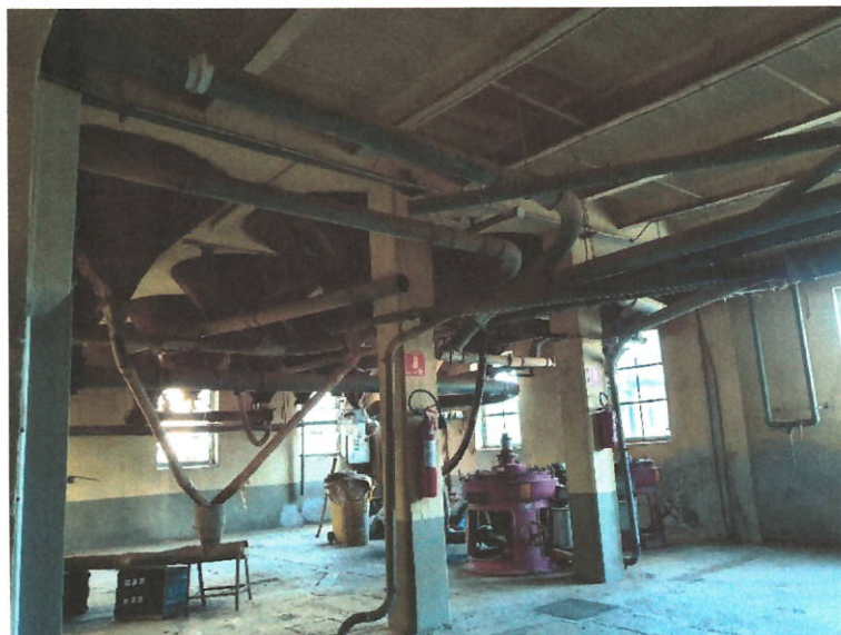
Foto 14: area silos interni – corpo 3 a
