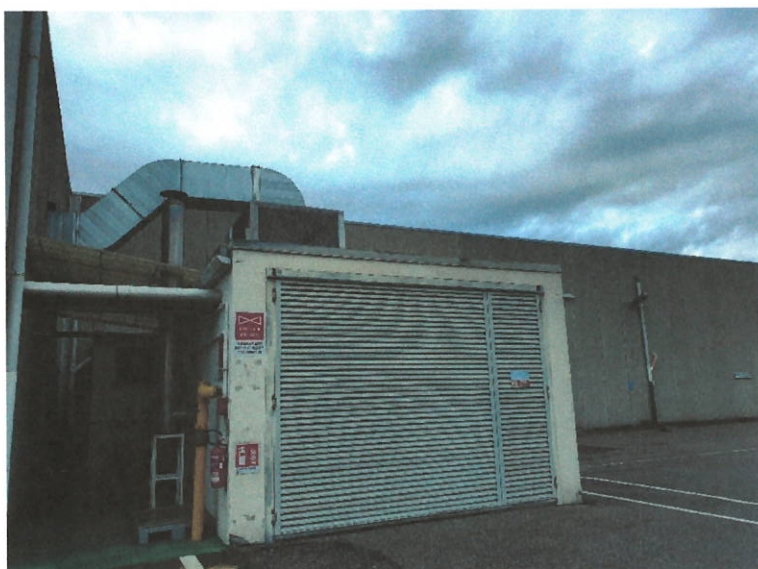
Foto 21: centrale termica “piccola” - corpo 6b - e area spogliatoi – corpo 6 a
