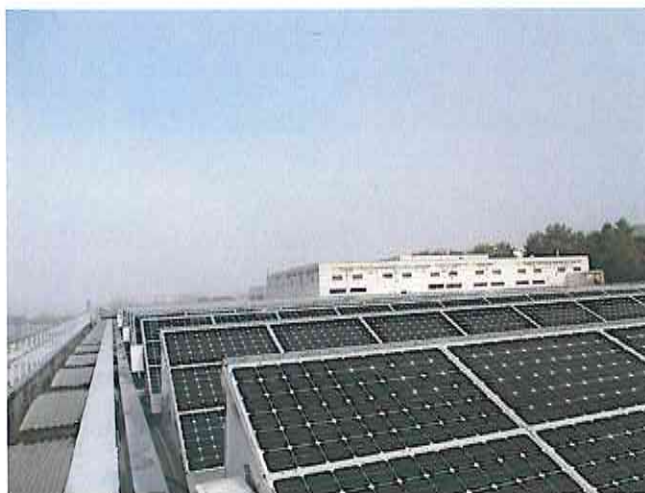
Foto panoramica di impianto
