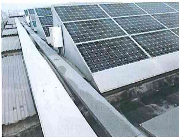
Quadri di stringa e canale portacavi
