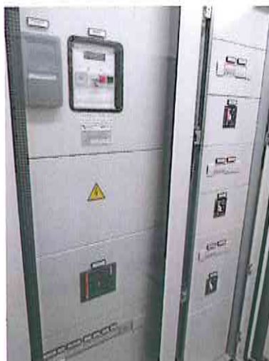
Quadro elettrico parallelo AC
