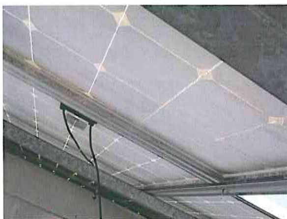
Particolare backsheet moduli fotovoltaici in copertura
