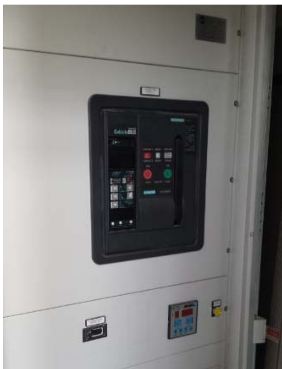
Figura 10: particolare interruttore generale gruppo
