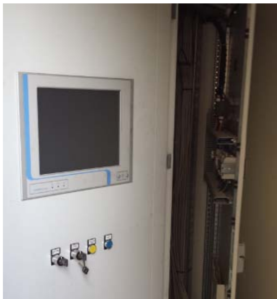
Figura 9: particolare pannello di controllo
