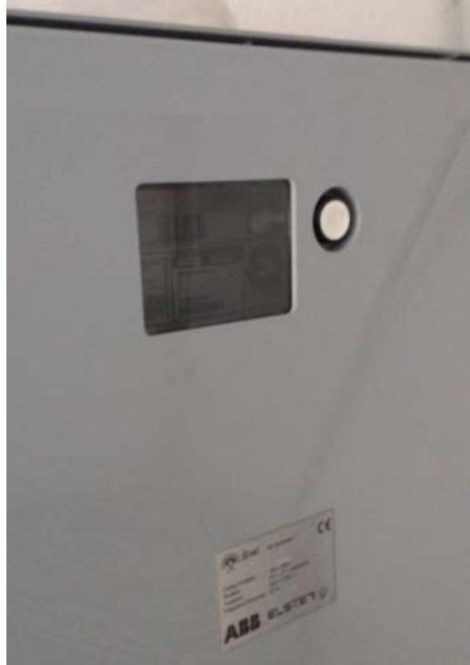
Figura 13: particolare contatore ENEL
