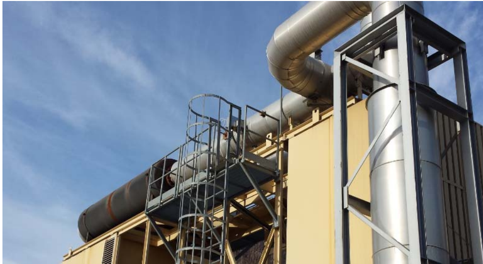
Figura 7: particolare depurazione gas di scarico
