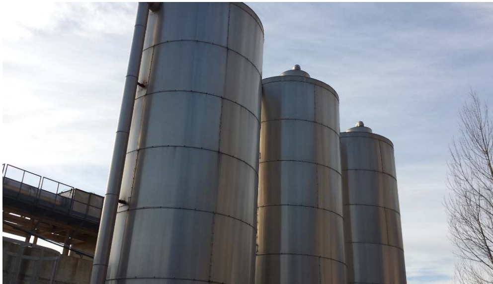
Figura 6: particolare serbatoi stoccaggio olio di palma
