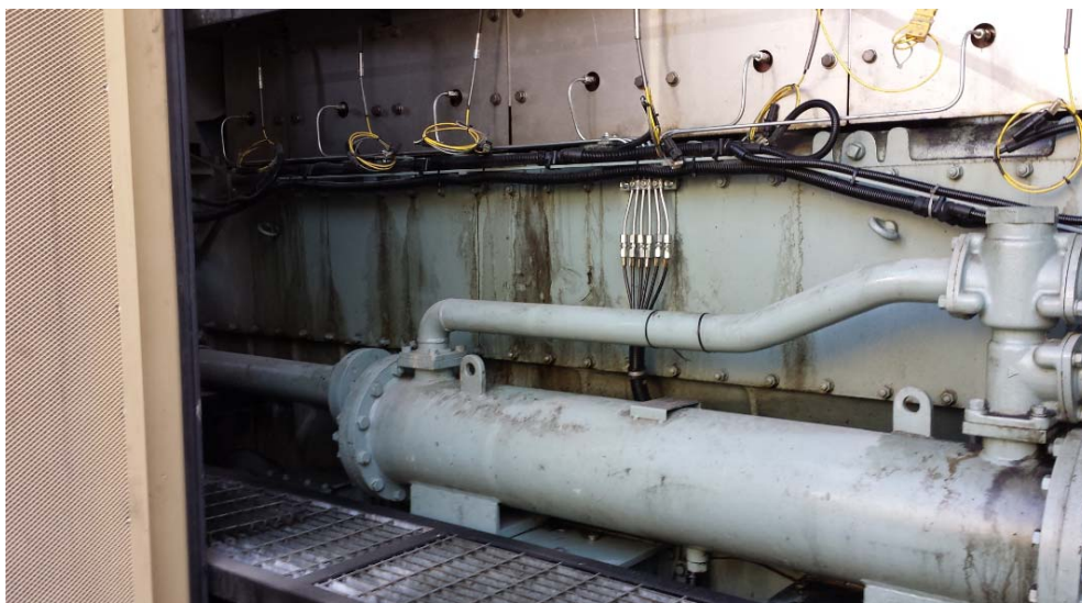
Figura 8: particolare interno motore
