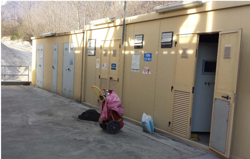
Figura 11: particolare cabina elettrica
