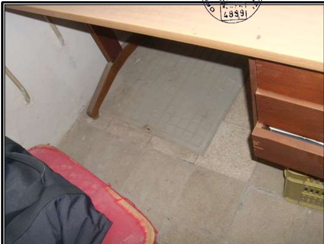
Foto 7: Botola di accesso cisterna sotterranea contenente acqua piovana
